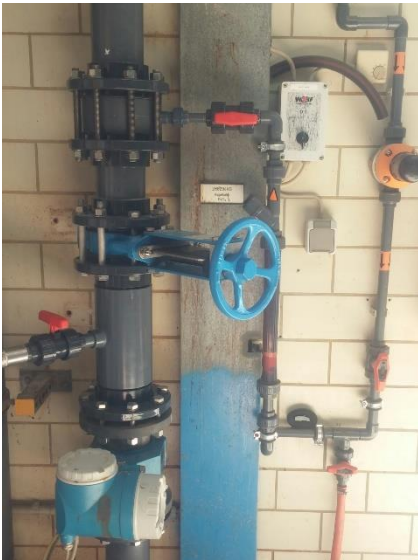
Eisen III Chlorid Dosierstelle
