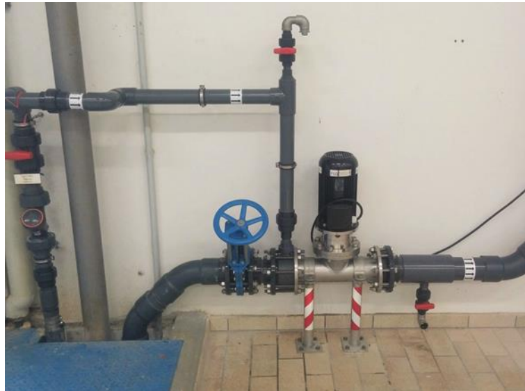
Kalkmilch Dosierstelle und Floccmix Motormischer
